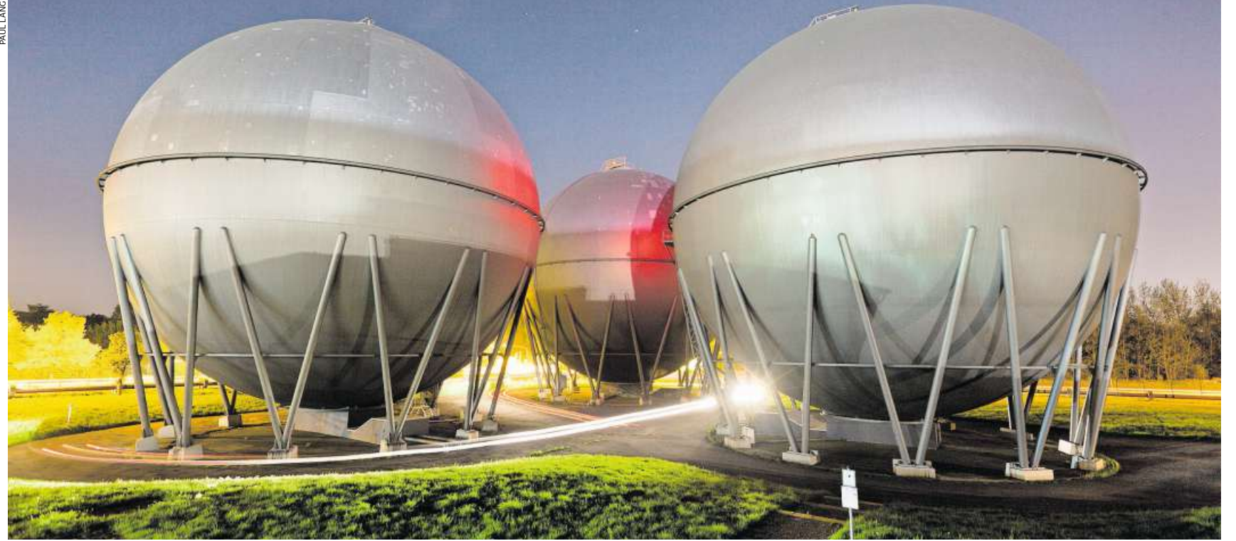
Die Gaskugelspeicher werden heute genutzt, um Lastspitzen einer Grossstadt zu decken. (Aachen, 18. April 2011)
